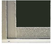
アルミ窓(複層ガラス)
